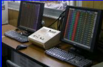
注入管理装置
