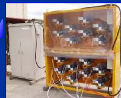
ポンプユニット(32連)
