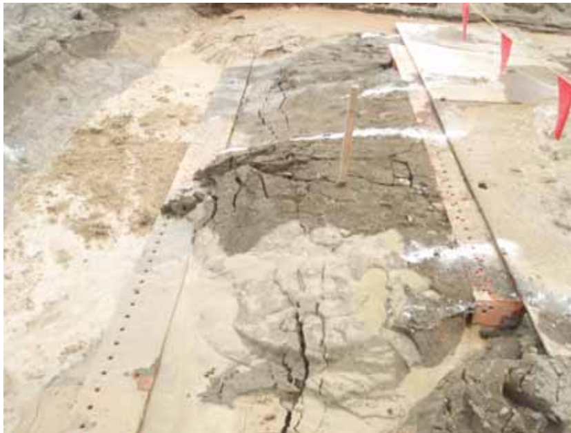
地盤変状の状況(側面)
