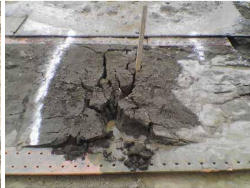
地盤変状の状況(正面)
