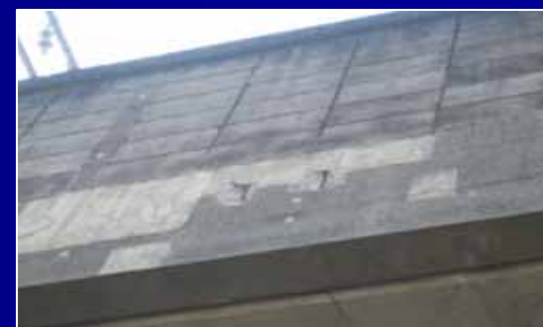
高欄の劣化状況
