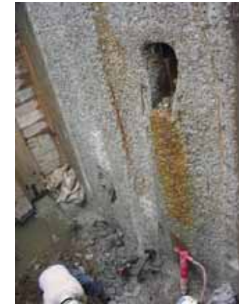
施工前（腐食状況）
