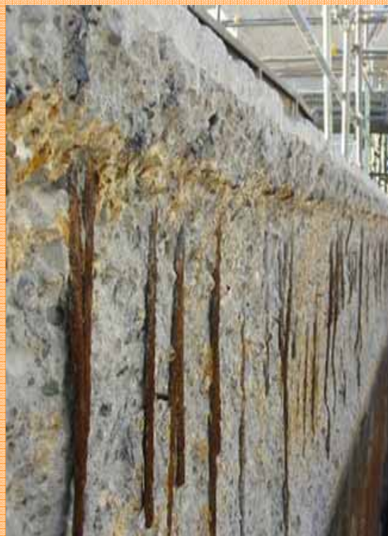
劣化部除去後の鉄筋腐食
