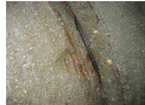
継手部からの漏水 (物理的な侵食)
