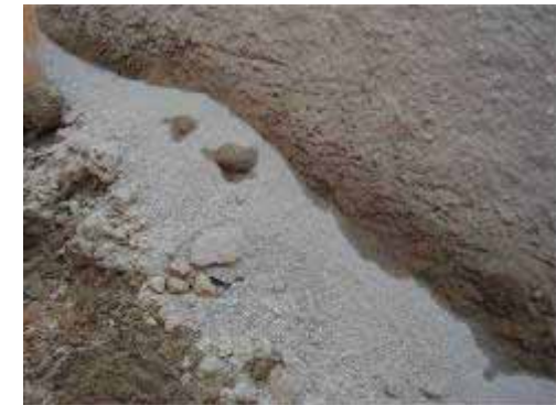
劣化したカバーコート (化学的侵食)
