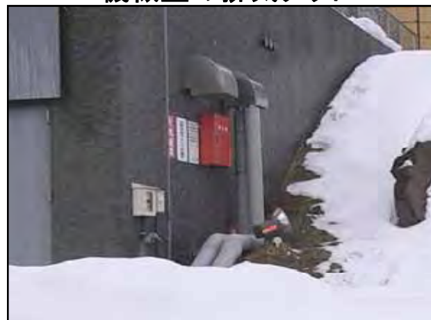
機械室の排気ダクト
