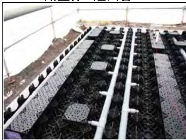
路盤体と通気管
