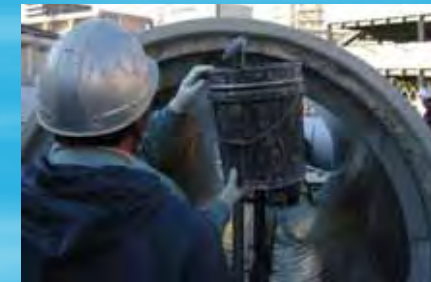
充填材流出状況
