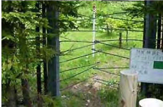
シカが脱出する際に生じた破損変形
