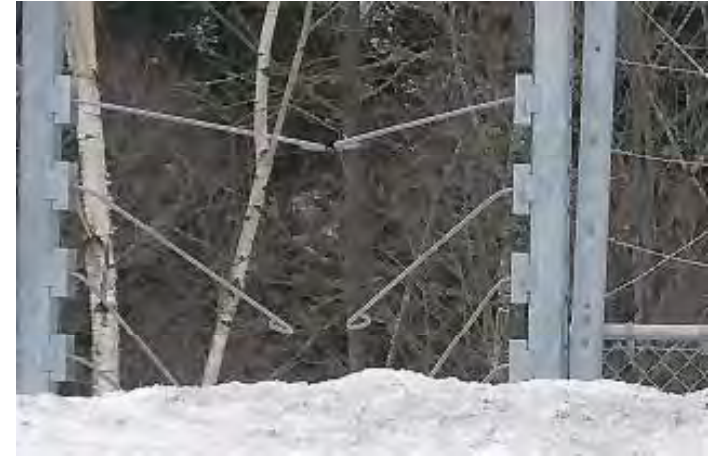
積雪による破損変形状況
