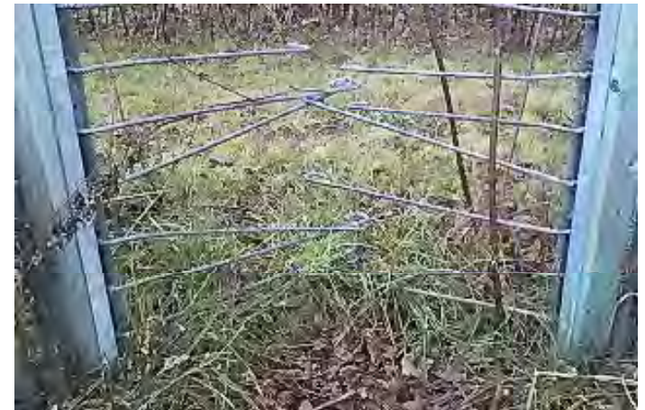
植物の生育による機能低下と破損状況
