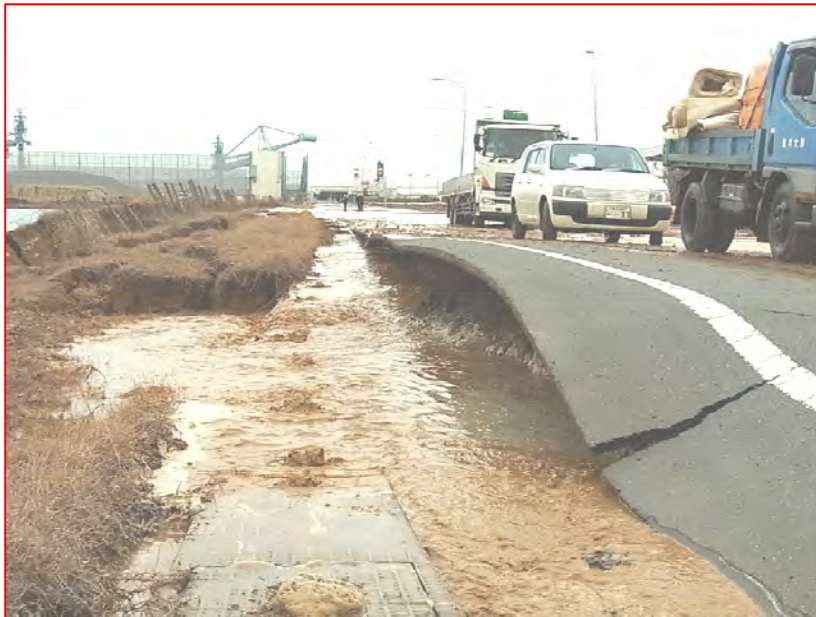
構内道路 (液状化現象)
