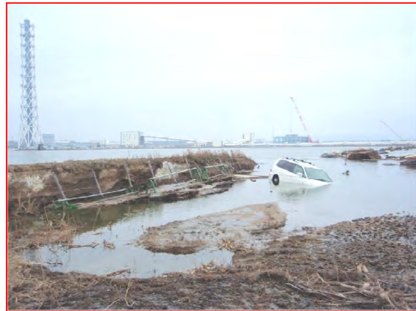
護岸 (液状化による側方流動)
