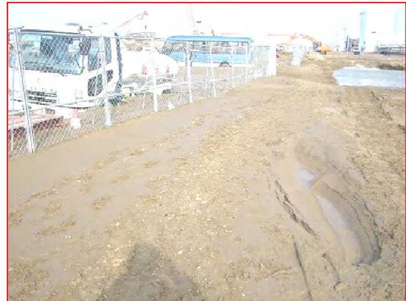
液状化による沈下
