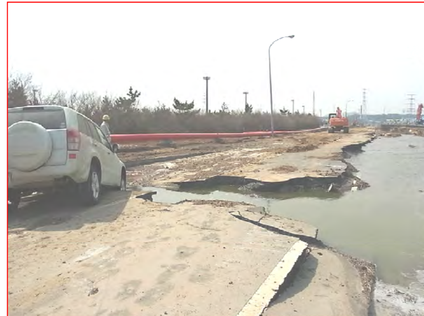
構内道路 (液状化現象)
