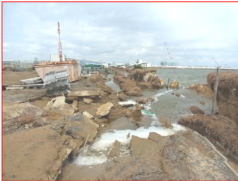
護岸 (液状化による側方流動)
