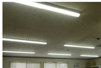
LED照明の採用
