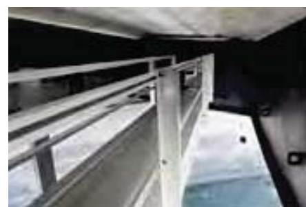
■KERO 設置状況
