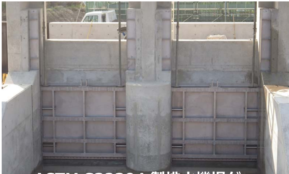
ASTM S32304 製排水機場ゲート
