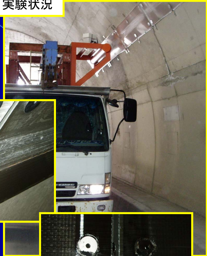
パネル損傷状況
