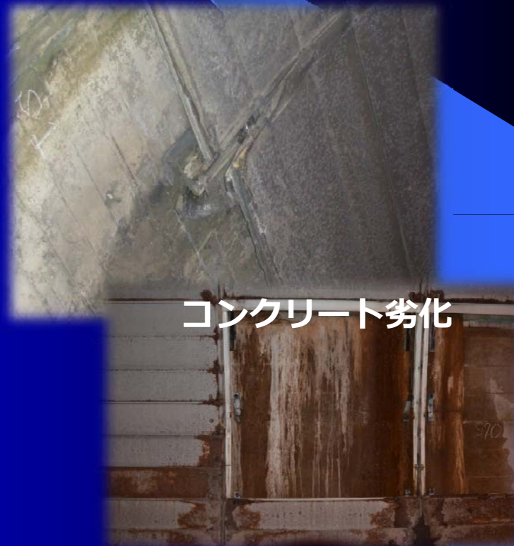
トンネル漏水防止板破損状況
