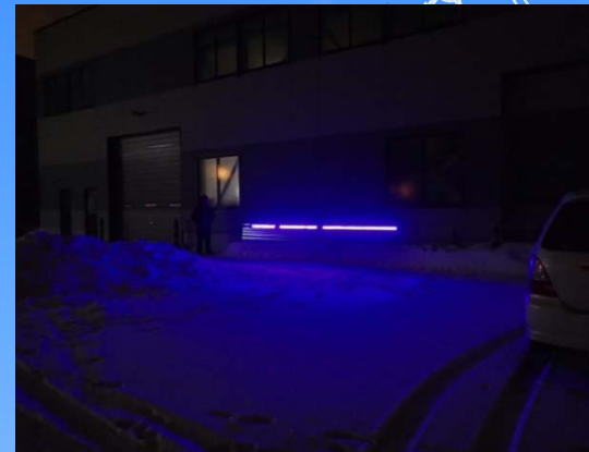
防雪板取付状況（屋外発光時）
