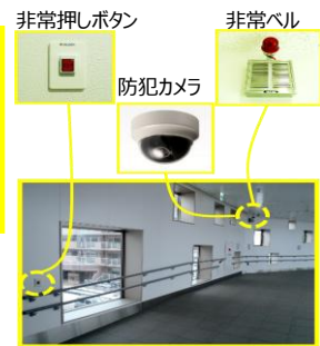
防犯・防災システムの設置
