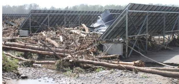
平成28年出水後 流木痕跡状況
