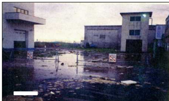
下水処理場越波浸水被害(H6.9)
