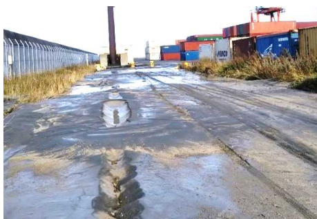
東港区コンテナ埠頭の液状化状況
