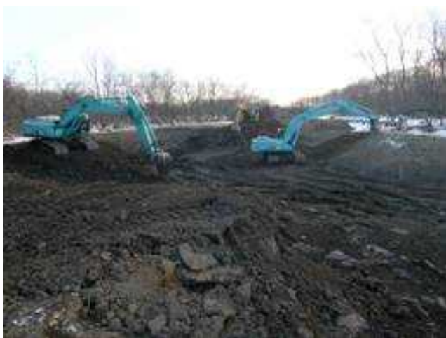
写真 旧川復元（茅沼地区）における掘削の様子 （掘削残土を堤防盛土材に利用）
