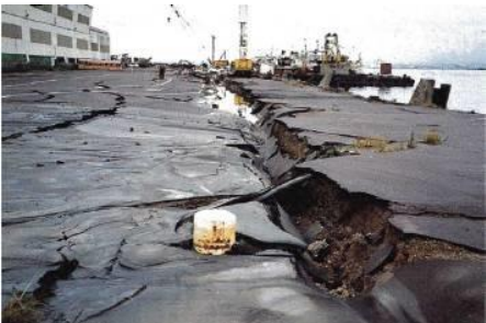
北海道南西沖地震の被害状況 函館港弁天地区 (H5.7)
