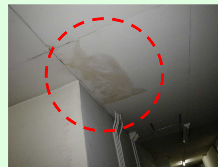
屋上からの漏水
