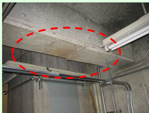
車庫の断熱材脱落
