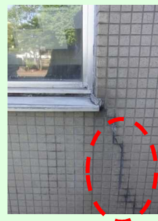
外壁ひび割れ
