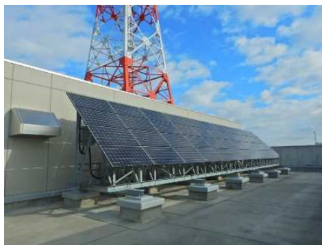
太陽光発電設備
