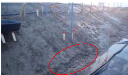
写真2-6 降雨による法尻崩れ(川表)
