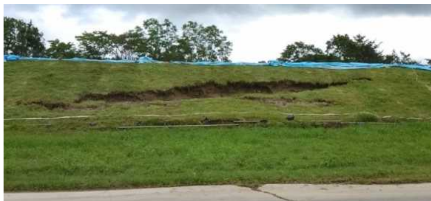
写真2-2 釧路川KP45.8付近で発生した法面すべりによる被災
