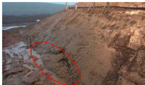
写真2-7 降雨による法尻崩れ(川裏)
