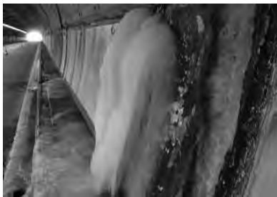
写真1 漏水に起因する「氷柱」
