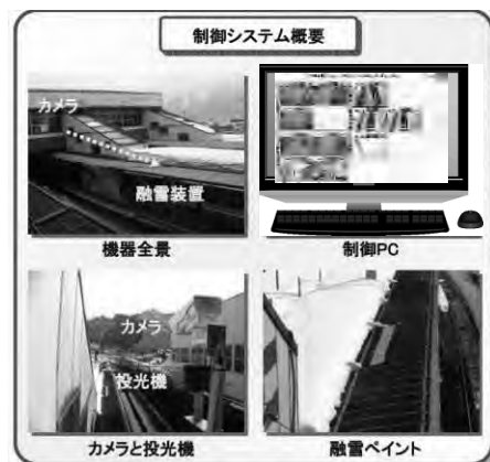
写真2 機器及び設置状況
