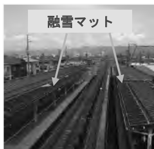
写真1 屋根融雪装置
