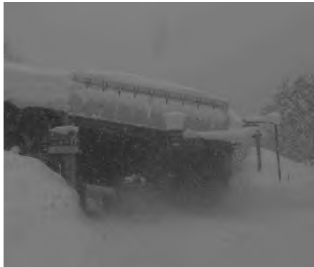
写真1. 雪底防止板・道路案内標識への着雪・冠雪
