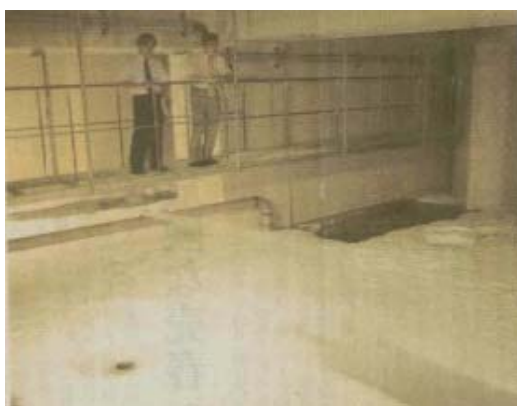
「汐留アネックスビル」地下1階にある氷蓄熱槽 (H16.7.26毎日新聞より)
