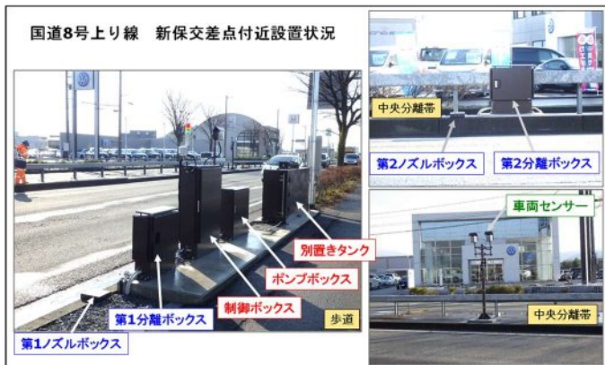
図5 上り線の定置式散布装置の設置状況
