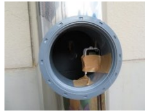
(写真-3) 主管入口
