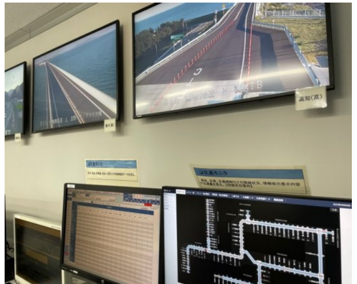
写真 2. 防災対策室で監視しているモニター
