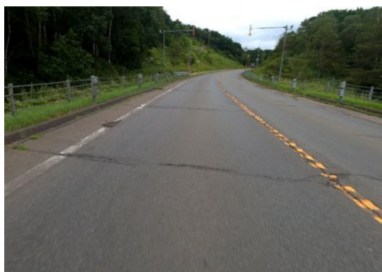
写真1 低温ひびわれの例
