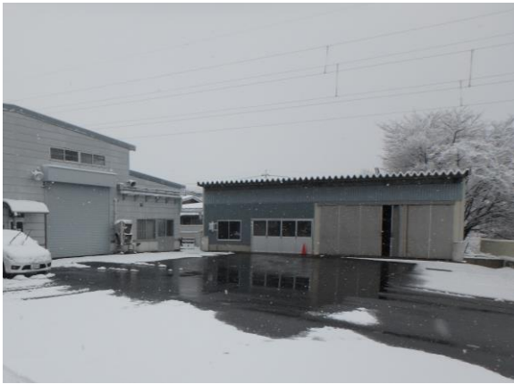
写真-1 無散水消融雪設備稼働状況 (2017/12/12)
