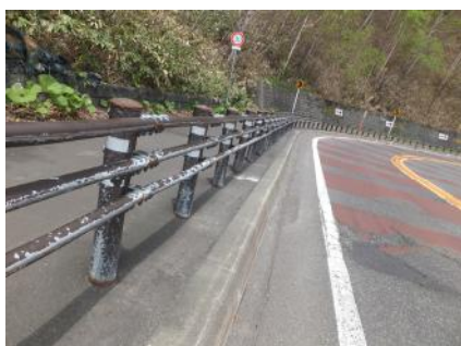
写真-2 除雪等に起因する塗装の剥がれの例
