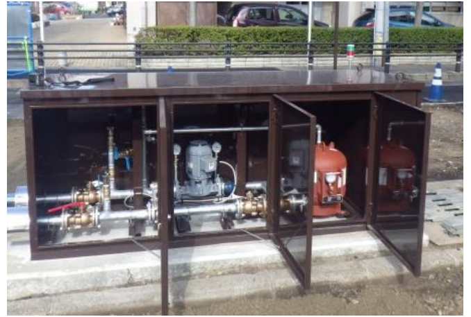
写真-4 循環設備
