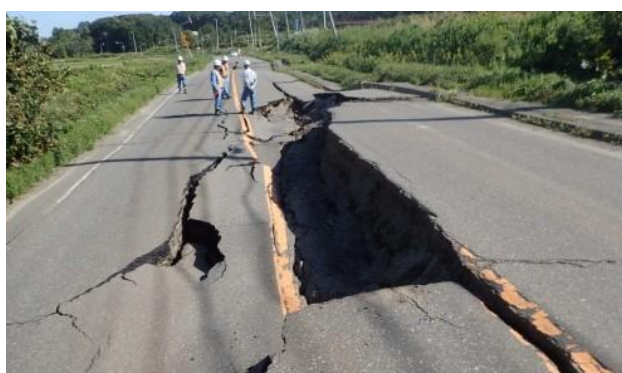
写真- 4 平取厚真線宇隆地区 道路陥没状況
