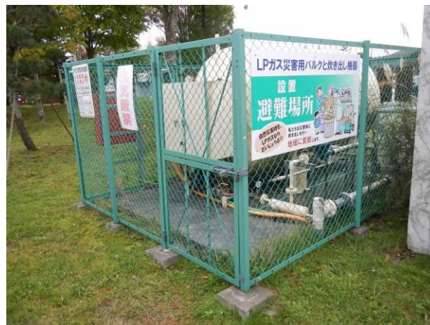
写真10 災害用LPガスパルク設置状況
