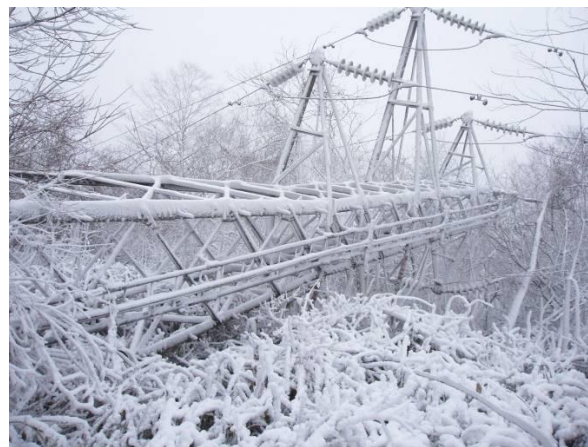
写真1 鉄塔倒壊状況 2)
