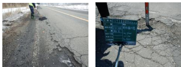
写真- 5 路面損傷状況 (左：平取厚真線 右：穂別鵜川線)
