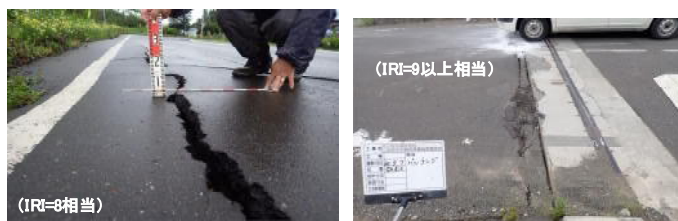
図- 7 亀裂・段差(左)・橋梁ジョイント部段差(右)
