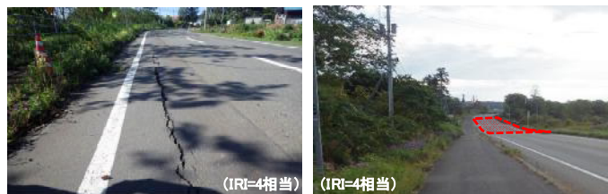
図- 4 路肩縦断クラック(左)・舗装不陸・路体沈下(右)
