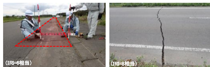
図- 6 路肩部沈下(左)・横断的な段差(右)
