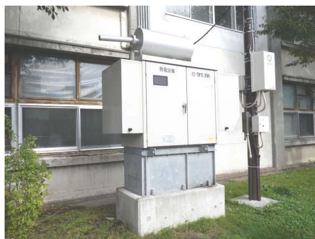
写真8 非常用発電機と防災行政無線設備
