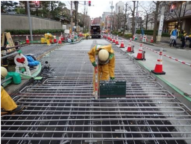
写真-1 放熱パネル
