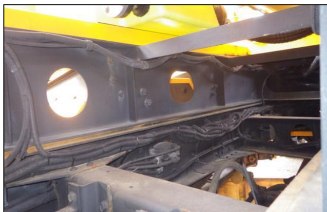
写真-4 塗料A シャシフレーム内側状況
