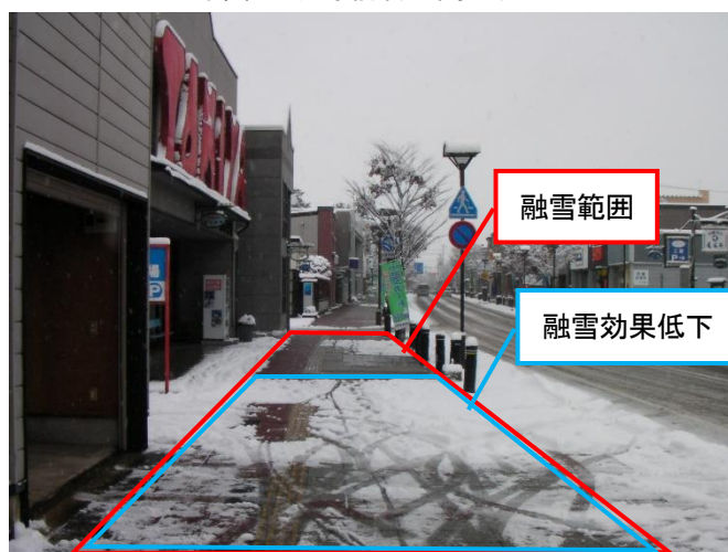
写真2 放熱管洗浄前の融雪状況
