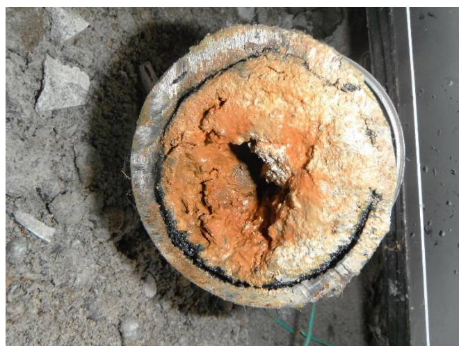
写真1 洗浄前管内閉塞状況
