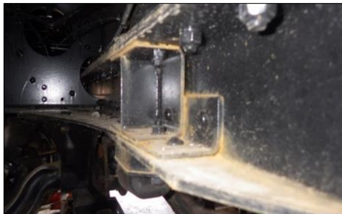
写真-8 塗料B 除雪専用車シャシフレーム内側状況
