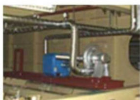
写11 桁内除湿機
