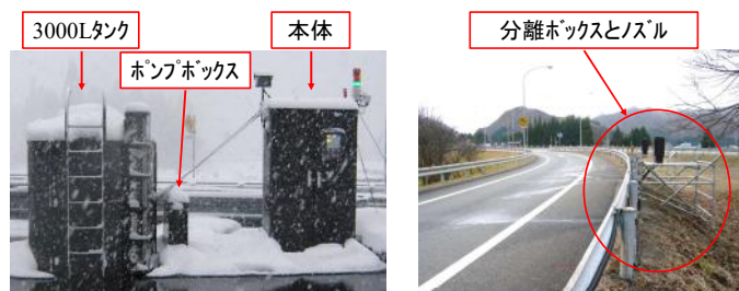
図2 湯沢ICに設置し定置式散布装置
