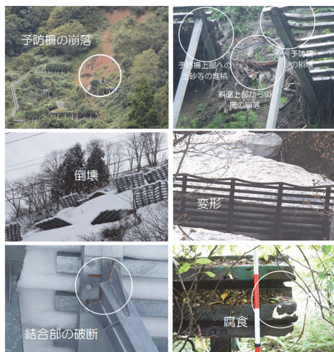
図1 雪崩対策施設の損傷例
