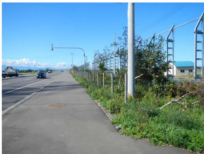
写真2 一般国道337号当別バイパスの除雪害
