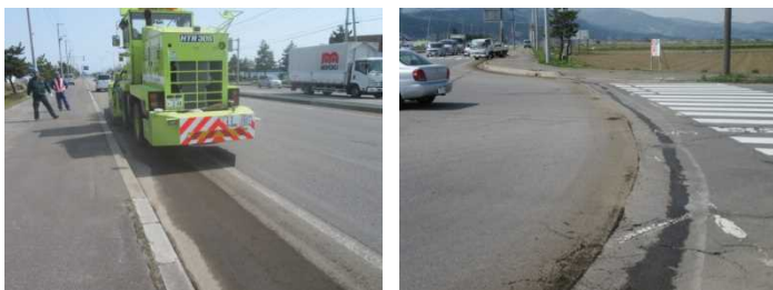
写真－10 塵埃取り残し状況
