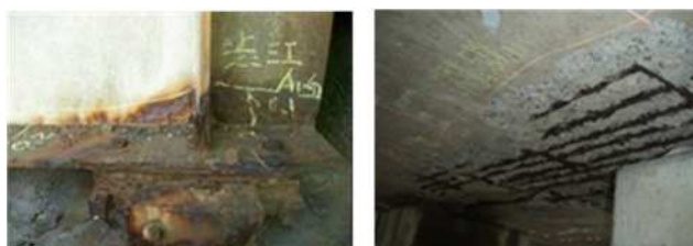
写真1 塩散布による構造物の塩害
