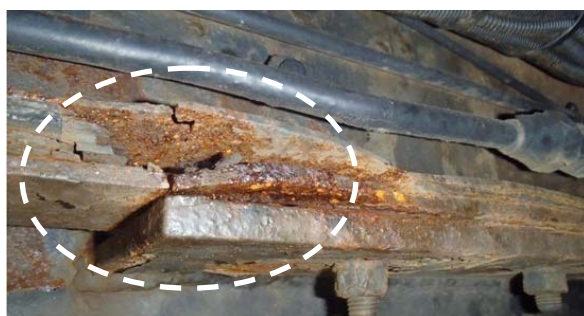
写真-2 フレームの腐食・亀裂状況
