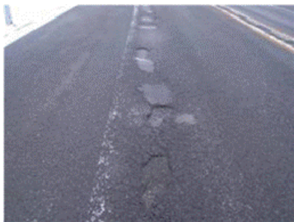
写真-1 排水性舗装の破損状況
