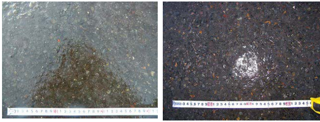
写真-3 凍結路面状況
