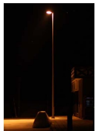
高圧ナトリウム照明
