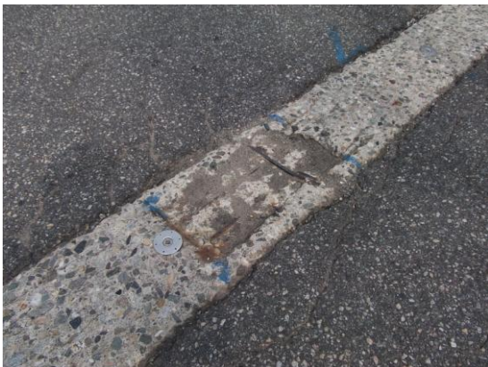
写真-1 (内部鉄筋の露出)
