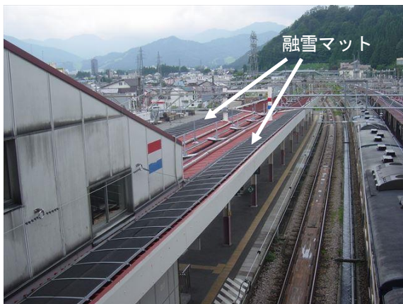
写真1 雪庇防止のための屋根融雪装置
