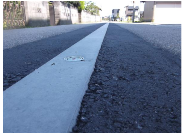
写真-9(舗装異常の初期)
