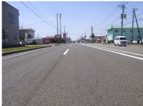
写真-2 10年経過後の機能性SMA箇所状況
