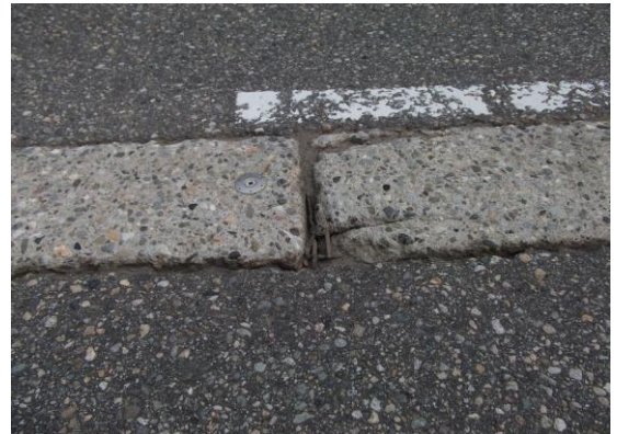
写真-2 (目地部の破損)
