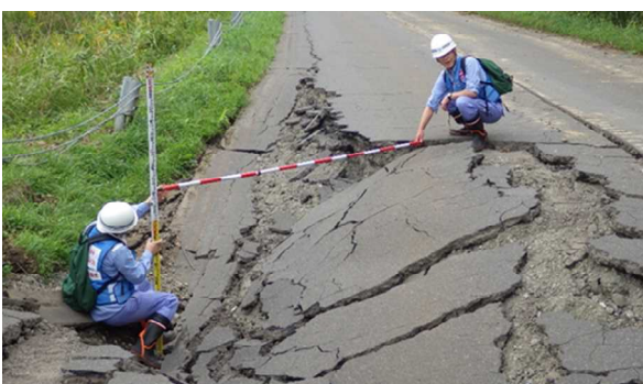
▲被災状況調査 (胆振東部地震時)
