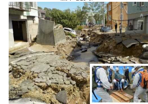
▲専門家による高度な技術支援 (胆振東部地震時 札幌市清田区液状化)
