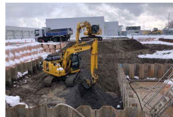
浸水対策 (函館空港)
