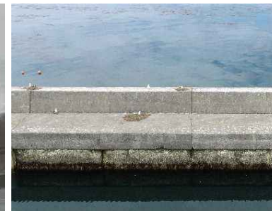
漁港施設（本土工）の老朽化 (歯舞漁港)
