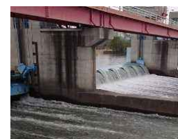
耐震性能不足の 頭首工
