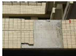
タイル落下により事故のおそれあり 外壁改修が必要（整備前の状況）
