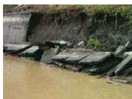
倒壊した用水路
