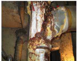
排水管の腐食により漏水が発生し、 配管改修が必要（整備前の状況）
