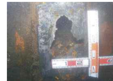
岸壁の老朽化状況(本体の腐食)
