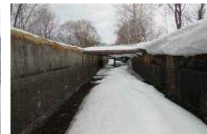
雪庇の影響を受ける用水路
