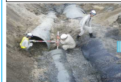
被災した導水路
