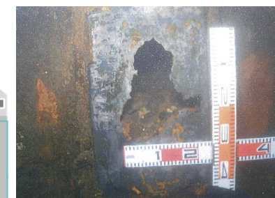
岸壁の老朽化状況(本体の腐食)
