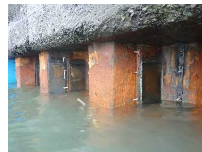
漁港施設の老朽化 (鋼矢板の腐食) (遠別漁港)
