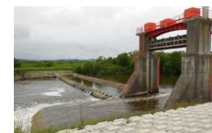
転倒のおそれがある頭首工
