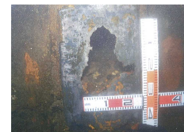
岸壁の老朽化状況(本体の腐食)
