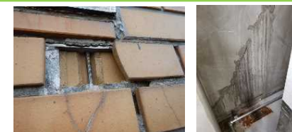
※内外壁劣化イメージ
