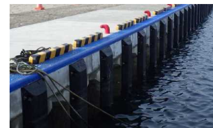
岸壁の老朽化対策例
