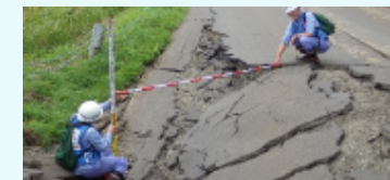
TEC-FORCEによる被災状況調査
