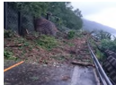
▲国道453号 斜面崩壊(千歳市)
