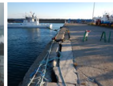
漁港施設の老朽化状況（庶野漁港）
