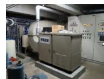
非常用発電設備(イメージ)
