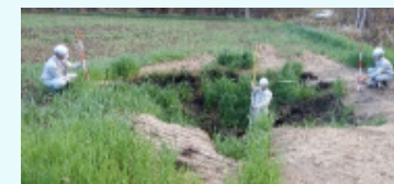
水土里派遣隊による被災状況調査
