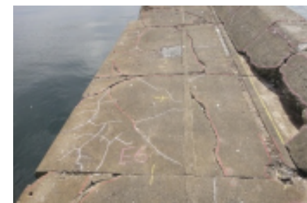
防波堤の老朽化状況
