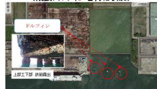
＜既設ドルフィン老朽化状況＞
