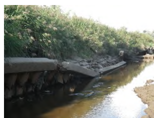
排水路の倒壊事故
