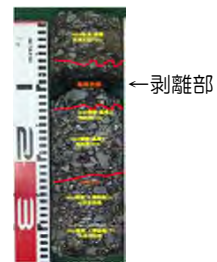
舗装の損傷（層間剥離） ※滑走路のアスファルトをコア抜きしたもの
