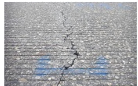
誘導路舗装の劣化状況
