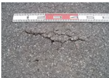
舗装の損傷（クラック）
