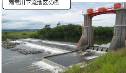
防災対策が必要な頭首工
