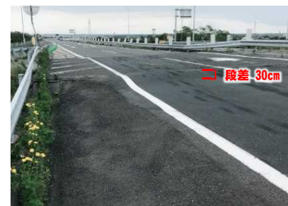
▲北海道胆振東部地震の被害による 日高自動車道の路面沈下
