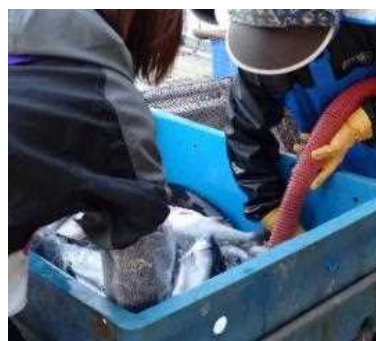
魚体洗浄に必要な海水の殺菌処理施設の整備（落石漁港）
