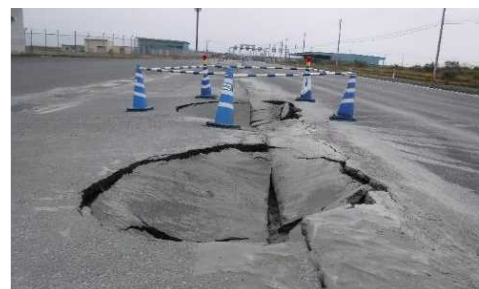
北海道胆振東部地震における液状化・陥没等の被害状況
