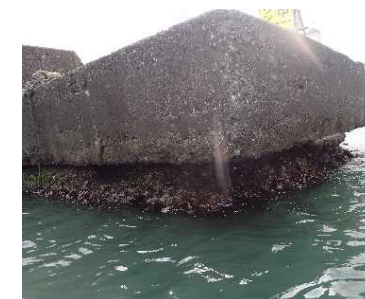
漁港施設の老朽化状況 (苫前漁港)
