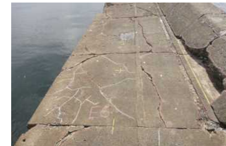
防波堤の老朽化状況
