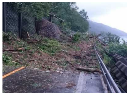
▲国道453号 斜面崩壊(千歳市)
