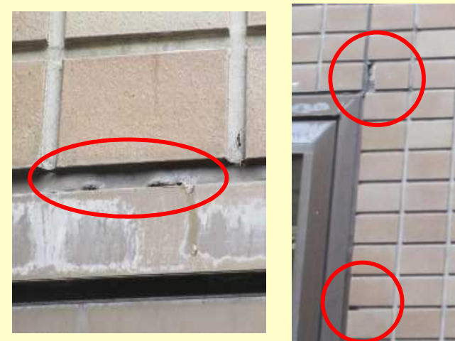
※外壁劣化イメージ
