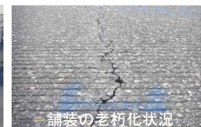
舗装の老朽化状況
