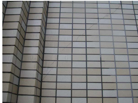
クラック及び浮きが生じている外壁
