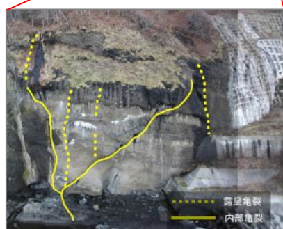
写真2：穴瀬トンネル直上斜面の亀裂
