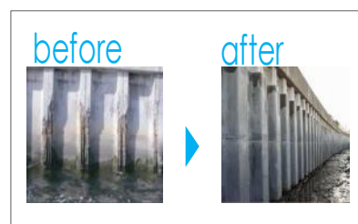
損傷した施設の機能回復事例
