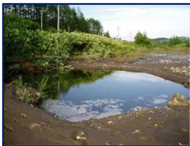
漏水による周辺地盤の陥没
