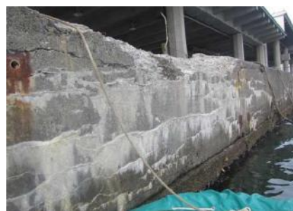
老朽化が著しい岸壁 (古平漁港)
