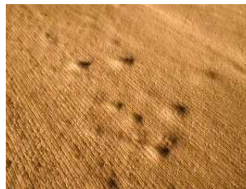
舗装の損傷（舗装の浮き上がり）
