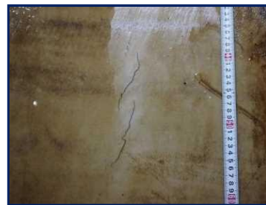
管底に発生したひび割れ
