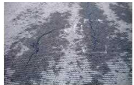
誘導路舗装の劣化状況
