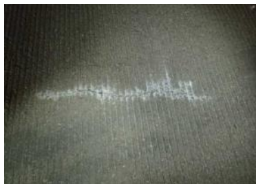
舗装の損傷（クラック）
