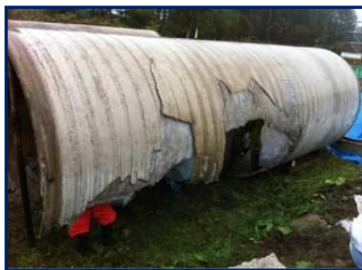
管底部の破損
