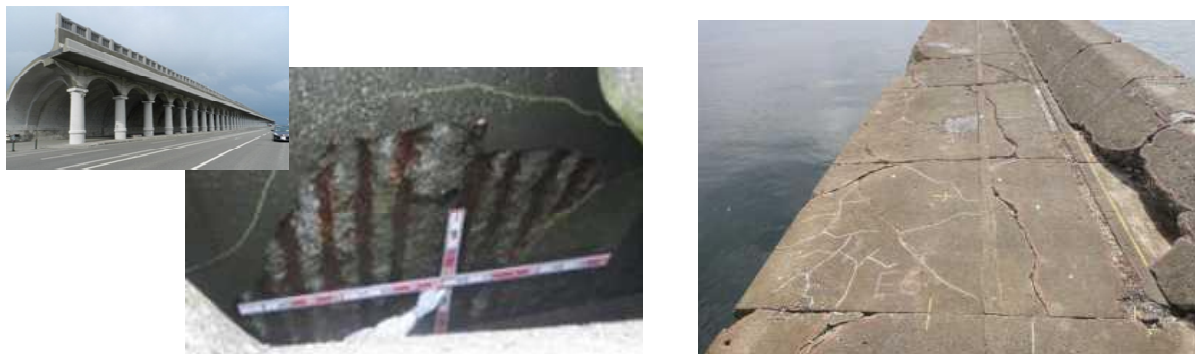
老朽化が著しい港湾施設（左は稚内港北防波堤ドーム、右は室蘭港防波堤）
