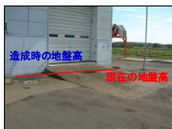
排水機場の地盤沈下
