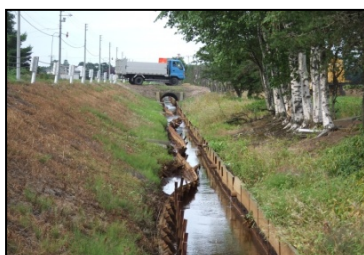
排水路護岸の劣化
