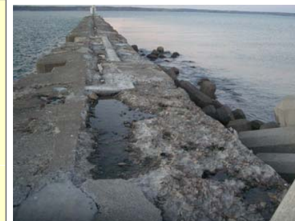
老朽化が著しい防波堤（霧多布港）
