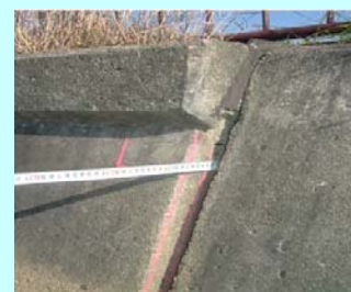
凍上により傾倒した水路
