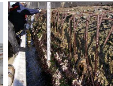
漁港施設の老朽化状況
