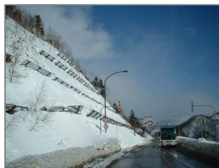
【雪崩予防柵の設置状況】
