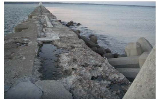
老朽化が著しい防波堤（霧多布港）
