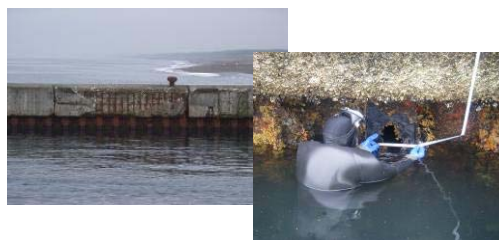
漁港施設の老朽化状況
