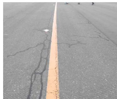
既設誘導路舗装の劣化状況
