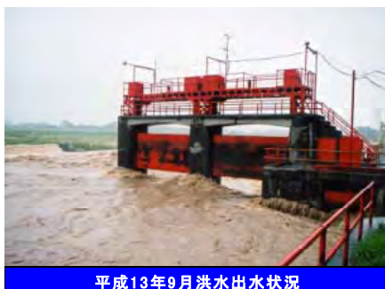
平成13年9月洪水出水状況
