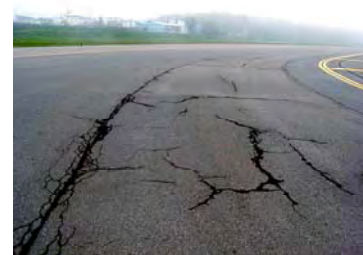
老朽化による舗装の破損状況（誘導路）
