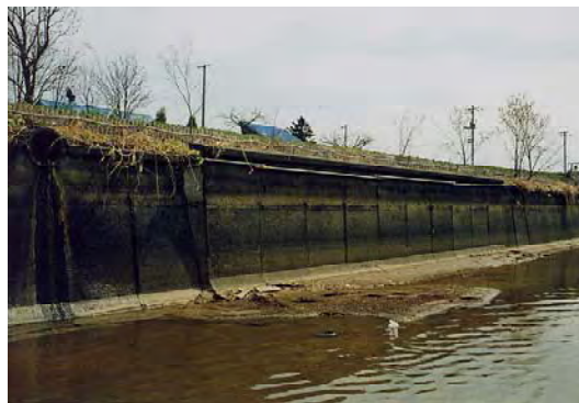
用水路の目地破損・傾倒しており、改修が必要な用水路
