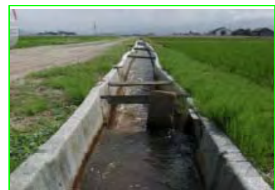
老朽化した用水路
