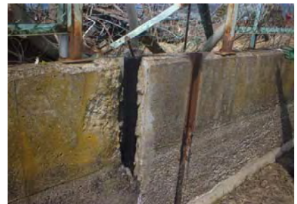
更新が必要な用水路 (国営造成土地改良施設整備事業)
