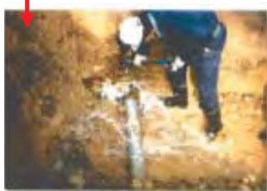
用水路の漏水及び老朽化状況
