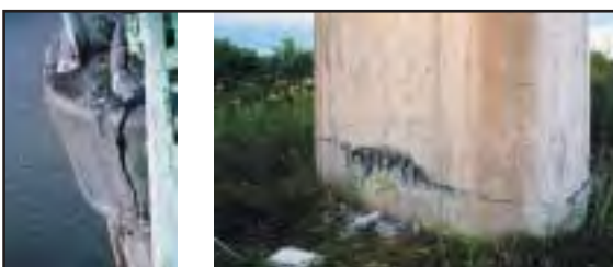
H15年十勝沖地震による被災状況
