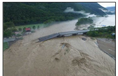
図-29 国道 274 号千呂露橋の被災状況
