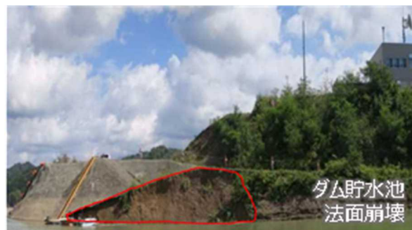
図－19 夕張シューパロダム被災状況
