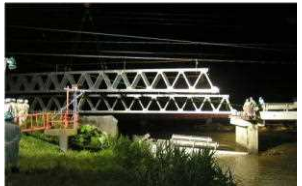
図-22 落橋した慶能舞橋の応急組立橋による復旧
