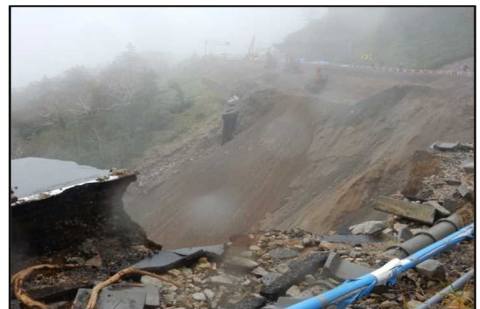
図-28 国道 274 号日勝峠の被災状況
