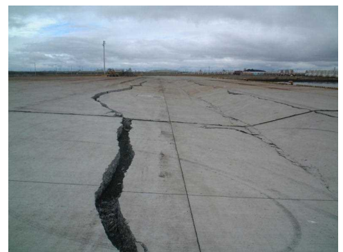
図－15 釧路港被災状況
