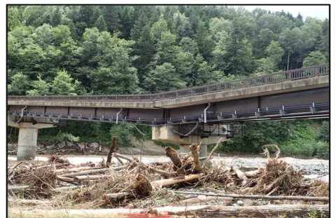
図-27 国道 273 号高原大橋の被災状況
