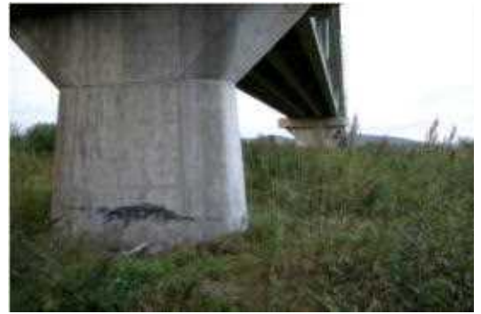
図－14 国道38号千代田大橋の橋脚被災状況
