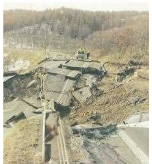
図－9 国道272号東阿歴内 路面及び法面崩壊
