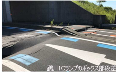
図－18 鶴川 IC ランプのボックス部段差
