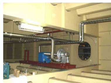
写真 18 桁内除湿ユニット
