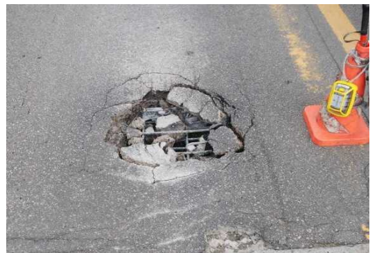
写真 14 RC 床版の局所陥没破壊（凍害+疲労）
