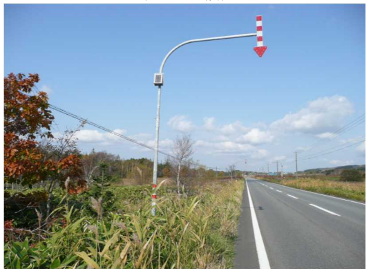
写真 17 固定式視線誘導柱（自発光式）
