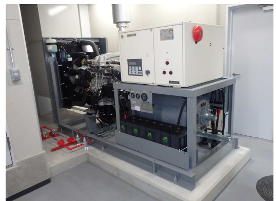
道東道白糠のトンネル電気室発電設備
