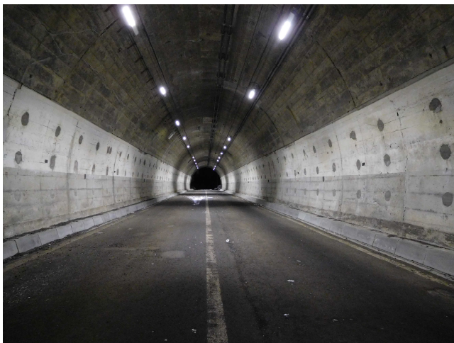
一般国道 451 号青山トンネルのトンネル照明
