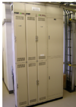
基地局装置 (旭川開建)
