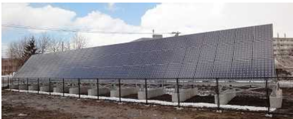
道の駅花ロードえにわの太陽光発電設備
