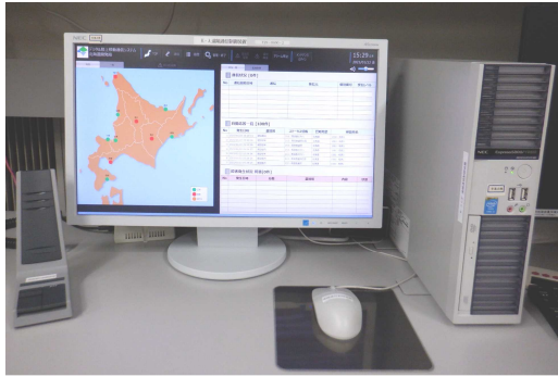
K-λ 遠隔通信制御装置(本局)
