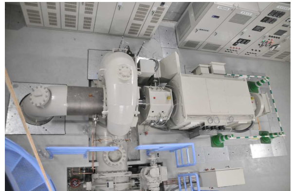
留萌ダムの小水力発電設備
