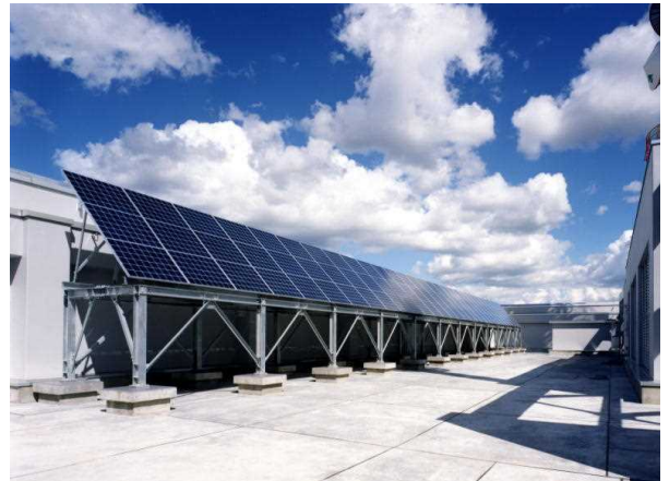
図 6-22 旭川地方合同庁舎 (平成 16 年新築庁舎に設置：15kW)
